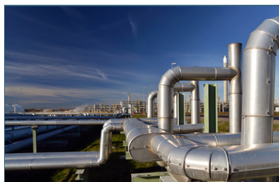
Abb. 5: ... Rohrleitungen können Lärm verursachen, ...
