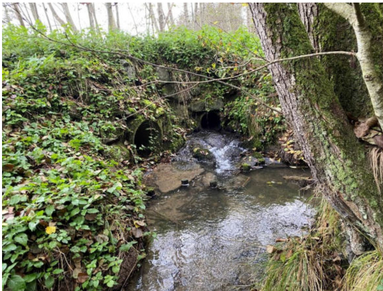
Graben 1: links Einleitung DN 600 in Seitenarm des Nopplinger Baches
