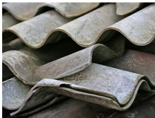
Abb. 12: Verschenken von asbesthaltigen Bauteilen ist verboten.
