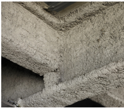
Abb. 3: Weltweit findet man Asbest noch als Spritzasbest, ...
