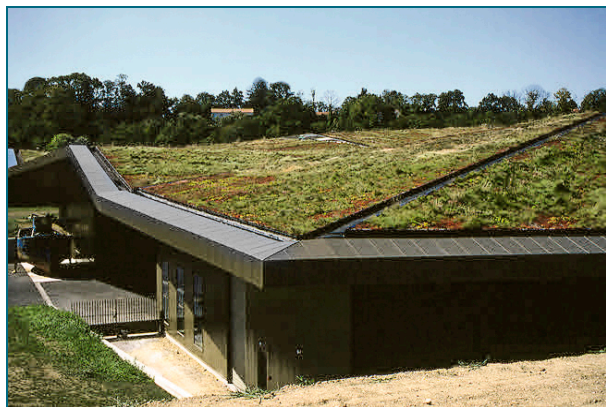
Abb. 4: Mit einem Gründach lassen sich bis zu 70 Prozent des anfallenden Niederschlags zurückhalten.
