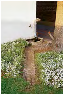
Abb. oben: Regenwasserversickerung in einer Mulde.
