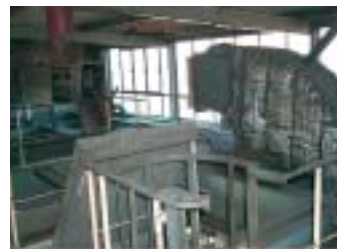
Lüftungsschacht mit Isolierung aus Alu-kaschierten KMF
