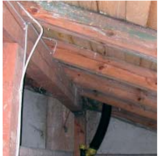
Dachstuhl mit Verdacht auf Holzschutzmittel
