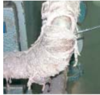
Rohrisolierung mit Asbestschnüren
