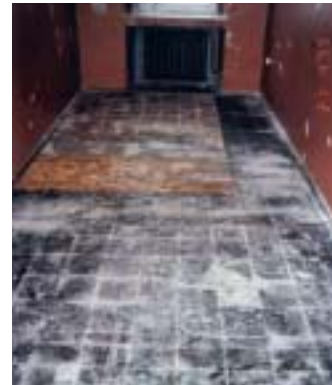
Schwarzkleber unter dem Fußbodenbelag
